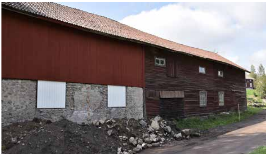
Större ladugårdscomplex från 1800-talets senare hälft väster om majstångsplatsen. Byggnadsdelen till vänster har bottenvåning i gjutmur. Björkberg 17:3.
